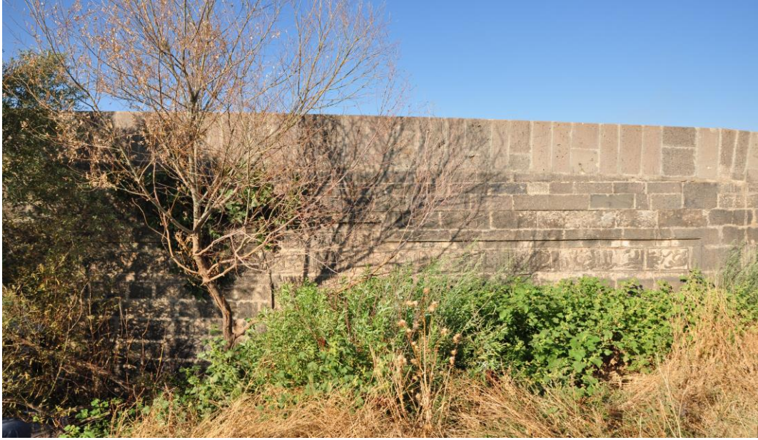
Resim 60: Köprünün sahil ayağı ile ilk gözü arasında bulunan inşa kitabesinin durumu
